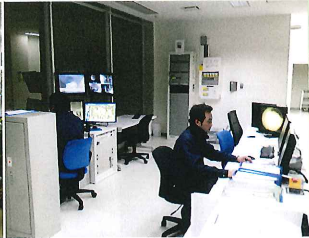
中央操作室（運転状況）
