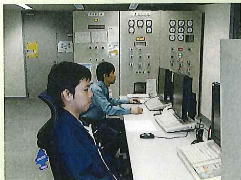
中央操作室での集中監視運転
