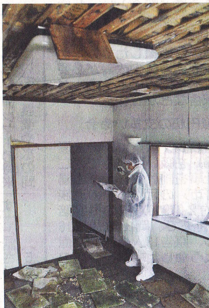
天井が抜け落ちた部屋で放射線量を測定する男性。3月23日、福島県大熊町
